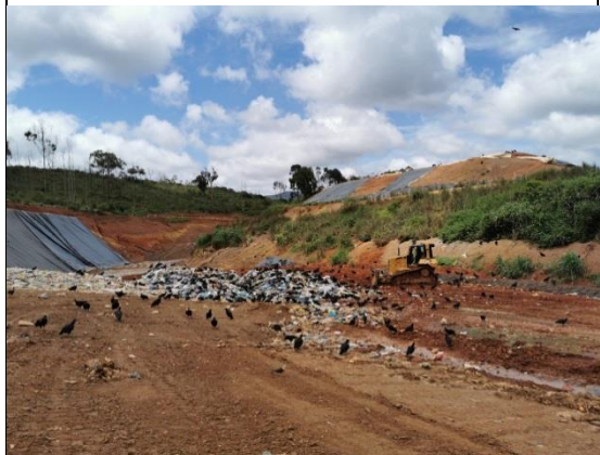
Figura 270– Operação do aterro sanitário de Mariana.
