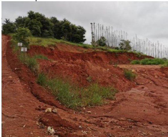
Figura 254– Antigo lixão municipal de Guaraciaba aterrado com solo. Observar processos erosivos na área
