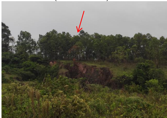
Figura 241– Antiga disposição de RSU realizada em processo erosivo de voçoroca (seta vermelha).
