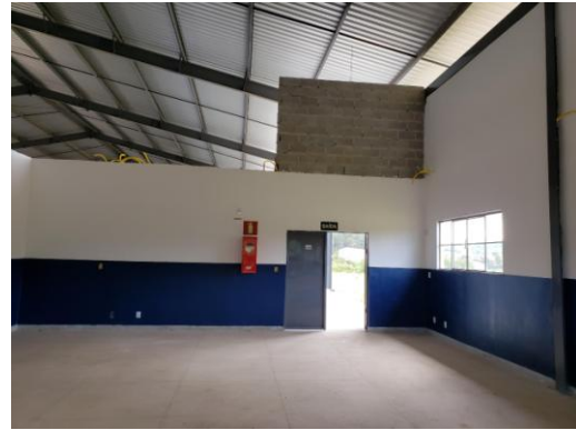
Foto 14: Vista parcial de sala com parede de bloco e parte elétrica não finalizada
