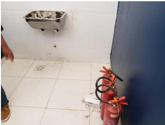
Foto 09: Vista parcial de uma sala onde estão guardados alguns extintores
