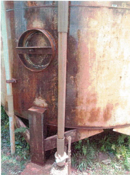
Imagem 03: Ação criminosa removeu todo sistema de cloração, reservatório de Mota (18/12/2021)
