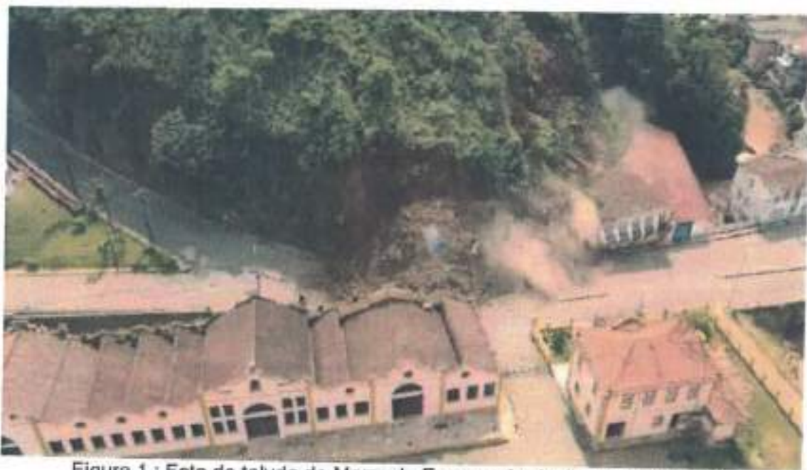
Figura 1 : Foto do talude do Morro da Forca após deslizamento de solo.
