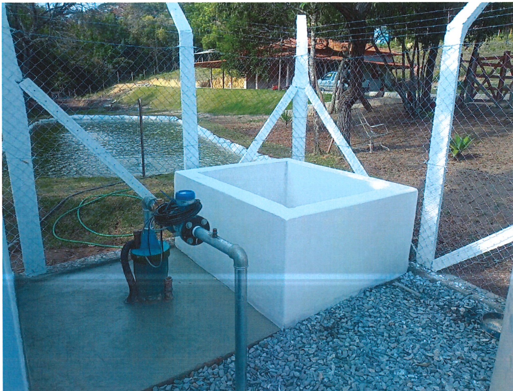
POÇO LOCALIDADE DE RIACHO, DISTRITO DE AMARANTINA
