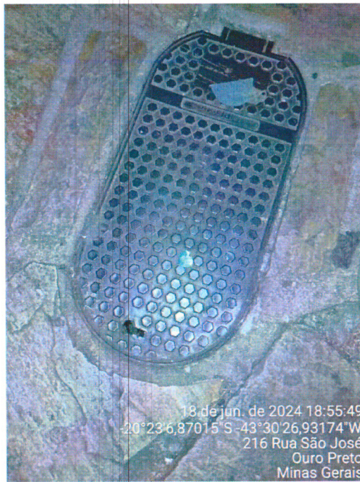
VISTORIA RUA SÃO JOSÉ (18/06/2024)
