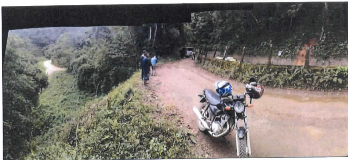
Figura 1: Vista geral do trecho avaliado, com talude, à esquerda, acesso, ao centro, e canal de adução em concreto, à direita (19/05/2019).
