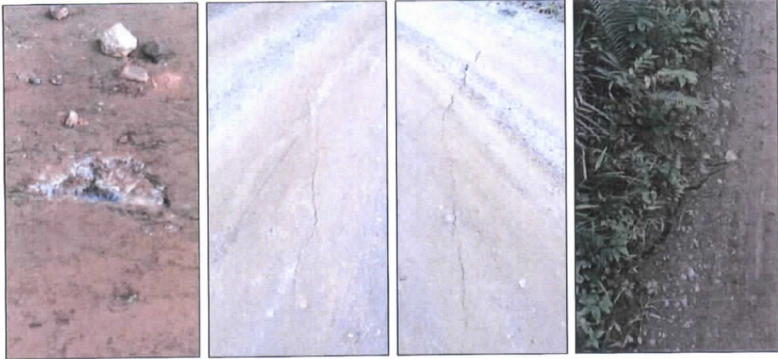
Figura 4: Ponto de infiltração do canal de adução, à extrema esquerda, e trinca, demais fotos. Fotos cedidas pelo colaborador Maynard (17/05/2019).
