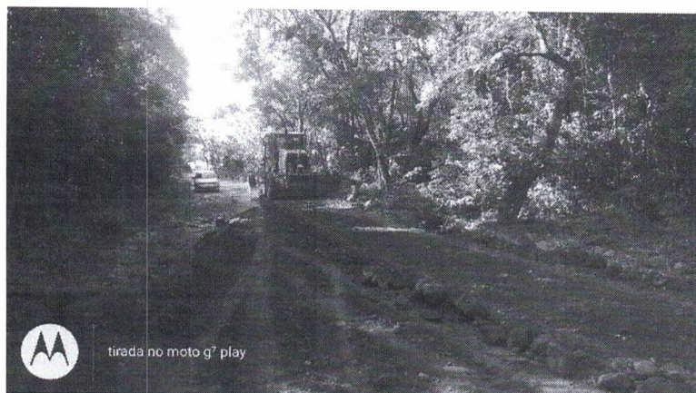
Figura 6: Visita a localidade Coqueiro para fiscalização de serviço em execução no local.
